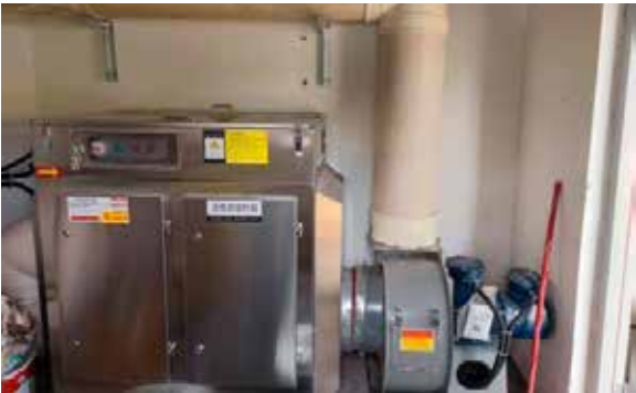
活性炭吸附設備
